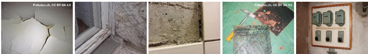
Exemples d'amiante faiblement lié: enduit, mastic pour fenêtres, colle pour panneaux, revêtements de sol, armoire électrique.
